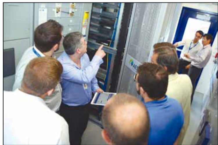
Vista interna do sistema: energy storage é solução para o aproveitamento da energia gerada por fontes intermitentes
